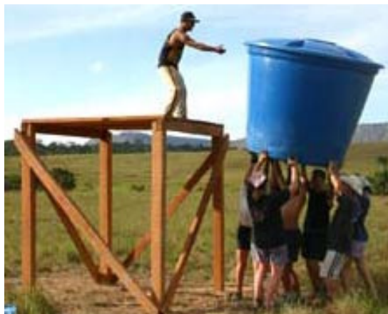
Ein Wassertank garantiert den dort lebenden Menschen den ständigen Zugang zu Trinkwasser und hilft somit auch gegen Krankheiten vorzubeugen.
